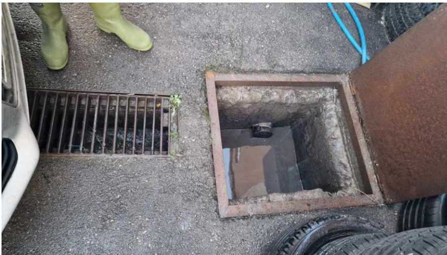
Sl.22. Namjenski prečištač sa taložnikom
