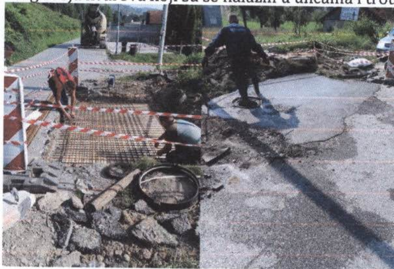
Rekonstrukcija šaht poklopca na glavnom cjevovodu ACC 500mm u Rakonjama
